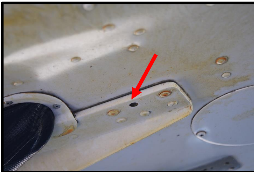
Fotografía No. 7 Vista del soporte con los remaches desprendidos.
